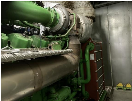
Teil einer KWK-Anlage
