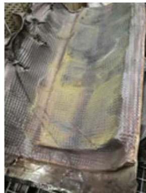
Gelber Staub unter einer Isolierung
