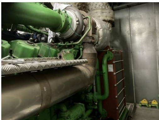
Pièce d'une centrale de cogénération
